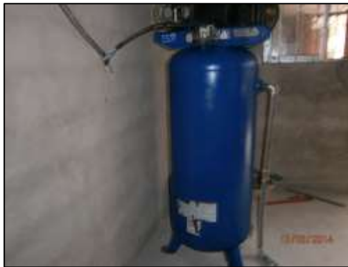
Fotografía No. 11 Compresor.
